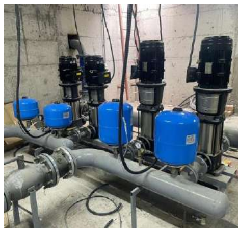
Насосная станция Кыргызстан, г. Бишкек ЖК Флоренция
