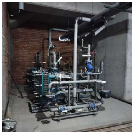
Насосная станция Узбекистан, г. Ташкент ЖК U-Tower
