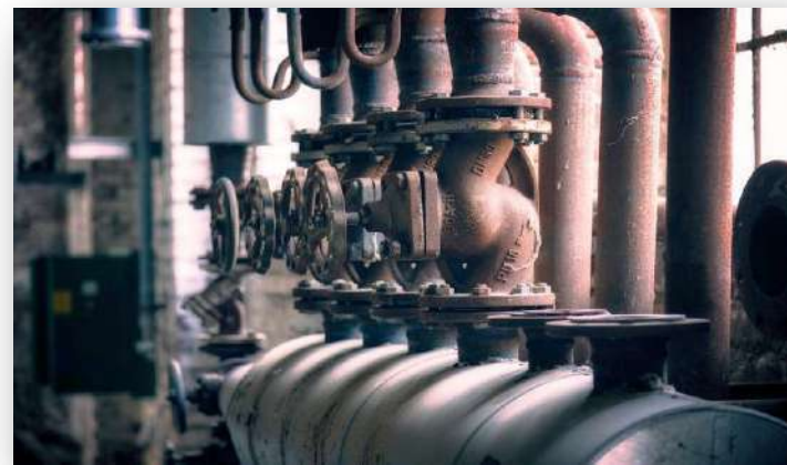
Насосные станции для КГП «Алматы Су»
