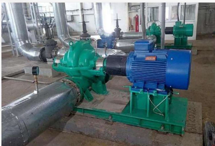
Насосные станции для ТОО «Алматинские тепловые сети»
