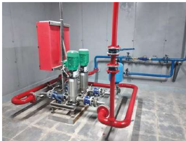
Насосная станция Узбекистан, г. Ташкент ЖК Mirzo Ulugbek
