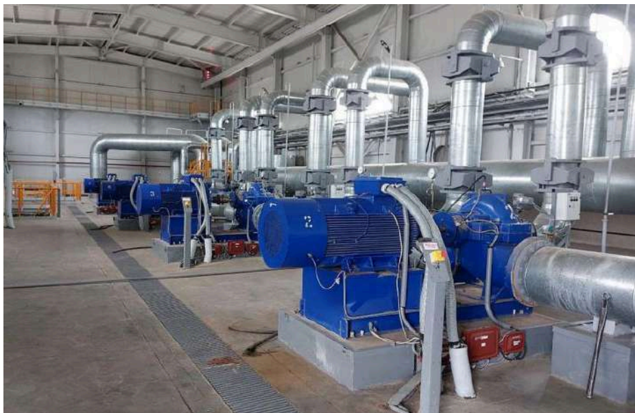
Насосные станции для АО «Астана-Теплотранзит»
