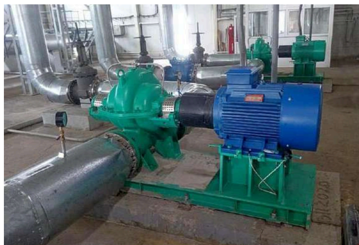
Насосные станции для ТОО «Алматинские тепловые сети»
