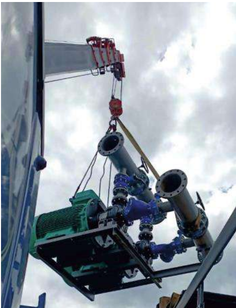
Насосная станция Узбекистан, г. Ташкент
