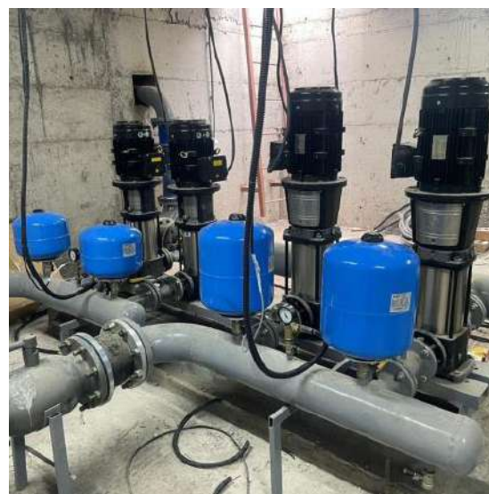
Насосная станция Кыргызстан, г. Бишкек ЖК Флоренция
