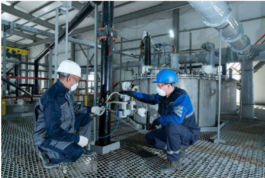
Оборудование для АО «НАК «Казатомпром»
